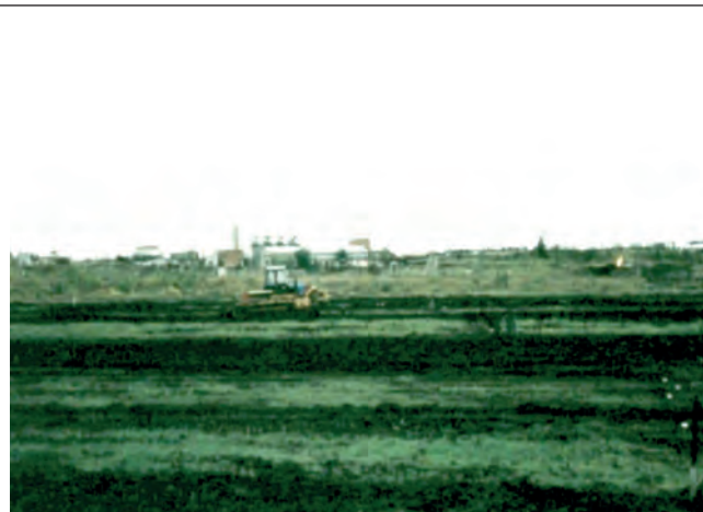
Рис. 2. Через 2,5 месяца после проведения работ
