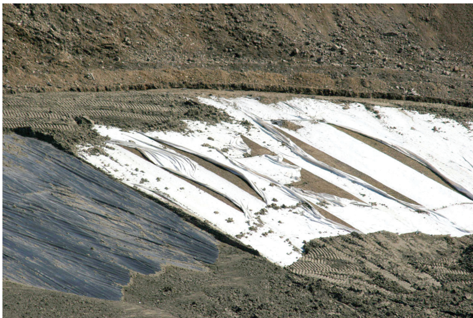
Рис. 7. Оголенный откос хвостохранилища на левом (противоположном) борту долины руч. Ветвистого. Видны следы разрыва и деформации (натяжения) геомембраны и сваливания кека на геотекстиль, не покрытый геомембраной (как сверху, так и снизу). Вертолетная съемка
